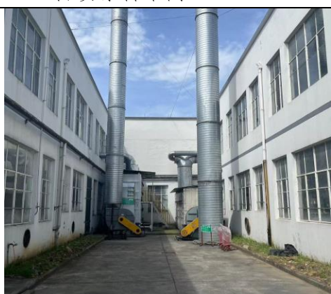
废气处理设施
