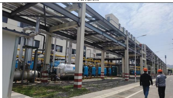
生产车间二旁室外设备
