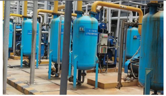
生产车间一旁室外设备
