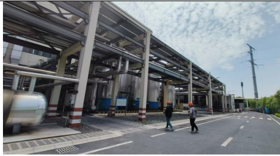
生产车间一旁室外设备
