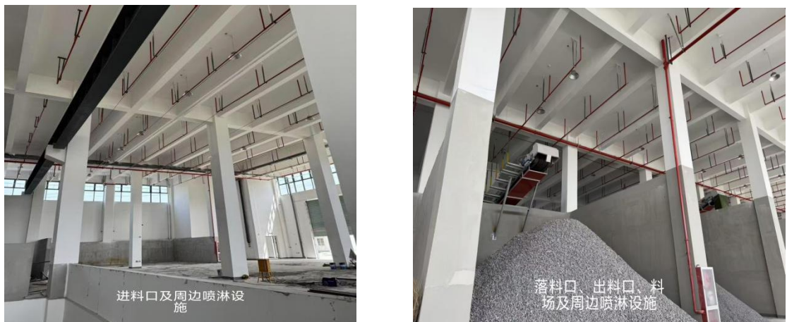
图 3-3 喷淋抑尘设施现场照片
