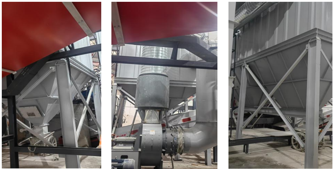
图 3-2 装修大件、建筑垃圾废气处理设施现场照片
