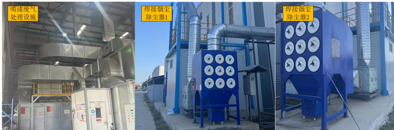
图 3-2 废气处理设施现状
