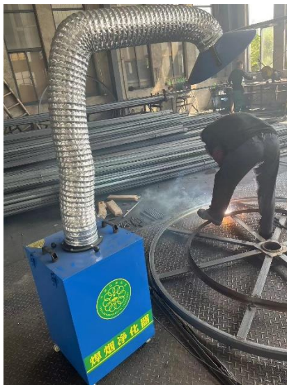
图 3-3 焊烟废气收集处理现状
